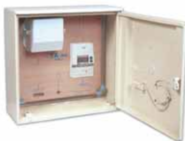
Coffret S15 équipé
