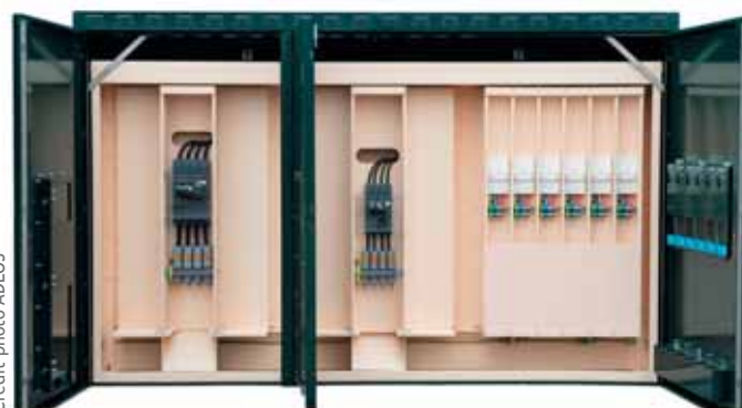
Vue côté branchements forains
