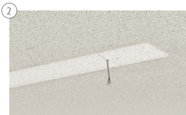
Le démontage d'anciens luminaires apparents laisse des traces visibles et inesthétiques au plafond.
