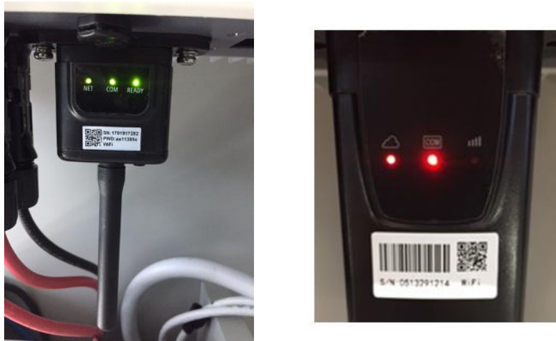
Figure 39 – État final des led
