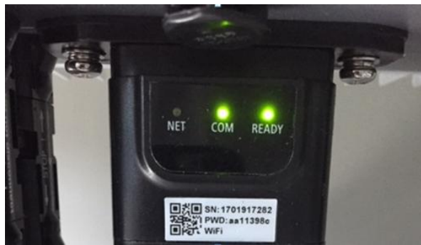
Figure 56 – État initial des led
