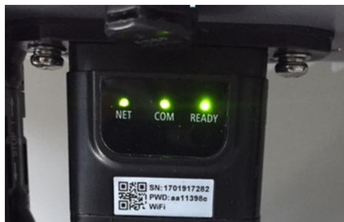
Figure 67 – État final des LED
