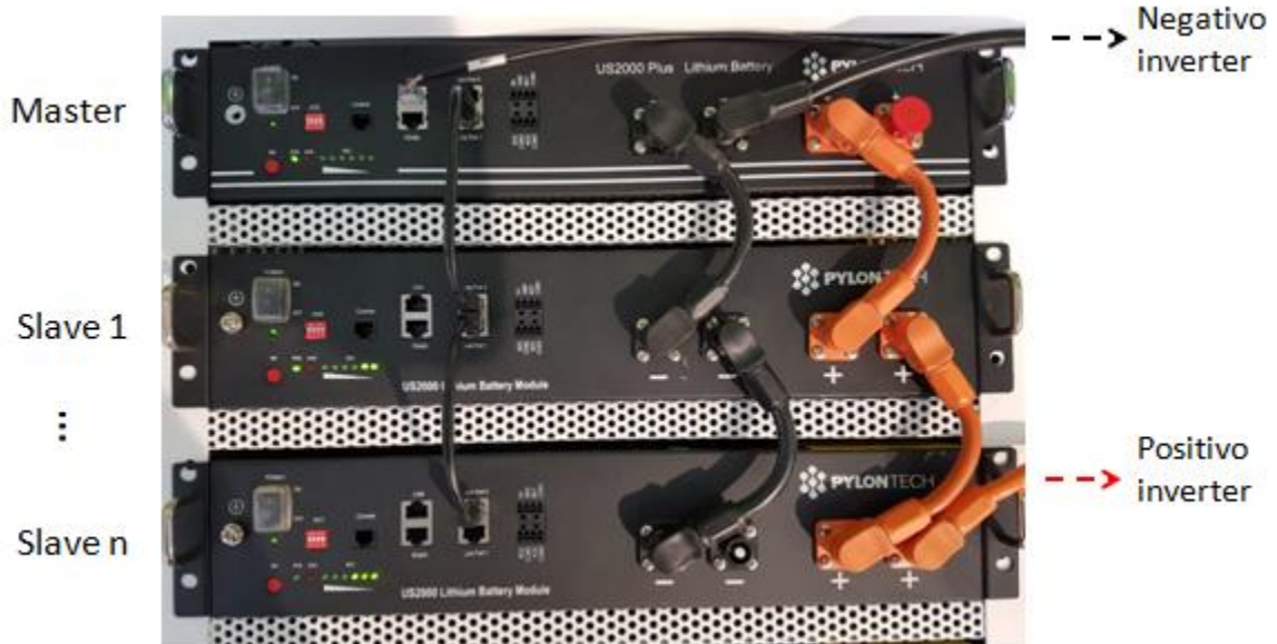
Figure 1 – Raccordement de trois batteries Pylontech en parallèle
