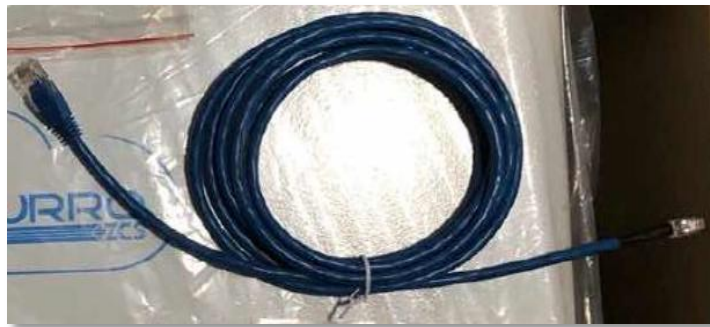
Figure 12 - Câble de communication entre l'onduleur et la batterie WeCo 4k4
