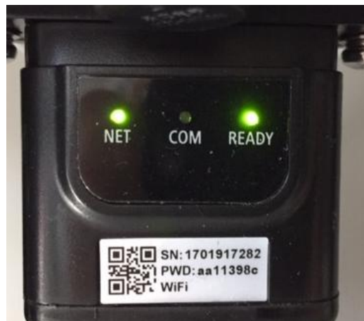
Figure 85 – État de communication irrégulière entre onduleur et adaptateur
