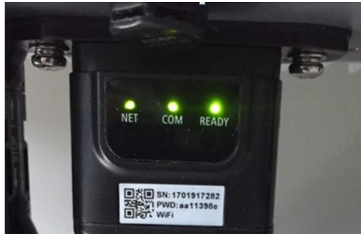
Figure 84 – État final des LED
