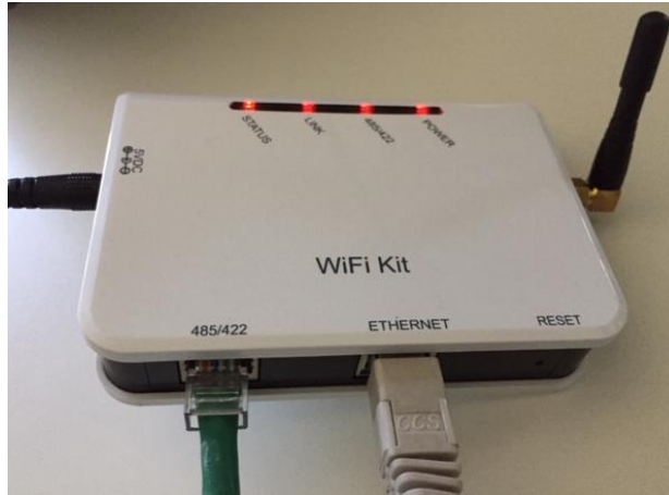
Figure 101 - Câble Ethernet connecté au datalogger
