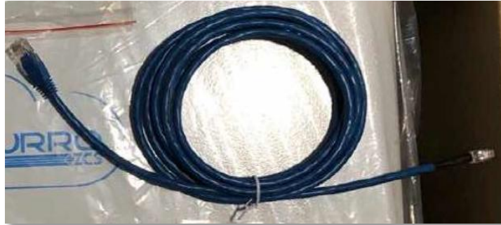
Figure 26 – Câble de communication entre l'onduleur et la batterie WeCo 5k3
