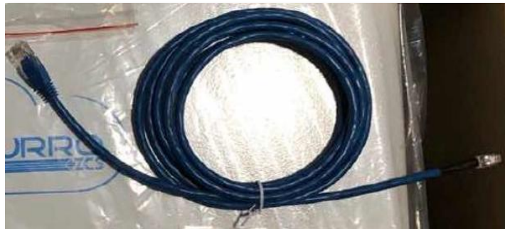
Figure 19 - Câble de communication entre l'onduleur et la batterie WeCo 4k4
