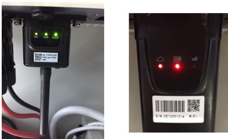
Figure 72 – État final des LED
