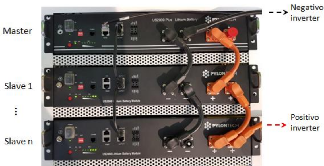
Figure 1 – Raccordement de trois batteries Pylontech en parallèle
