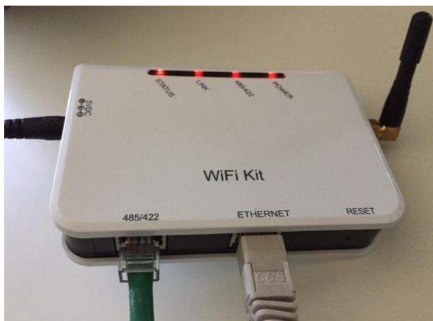
Figure 101 – Câble Ethernet connecté au datalogger
