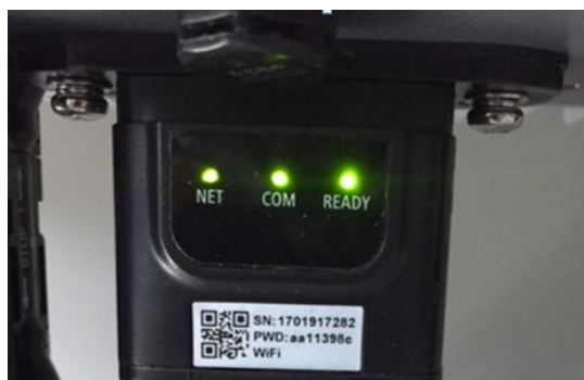
Figure 90 – État final des LED
