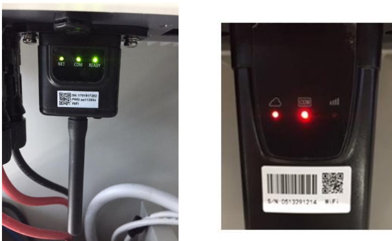
Figure 72 – État final des LED
