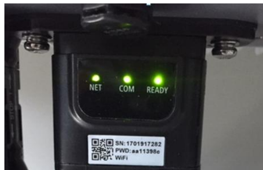
Figure 90 – État final des LED
