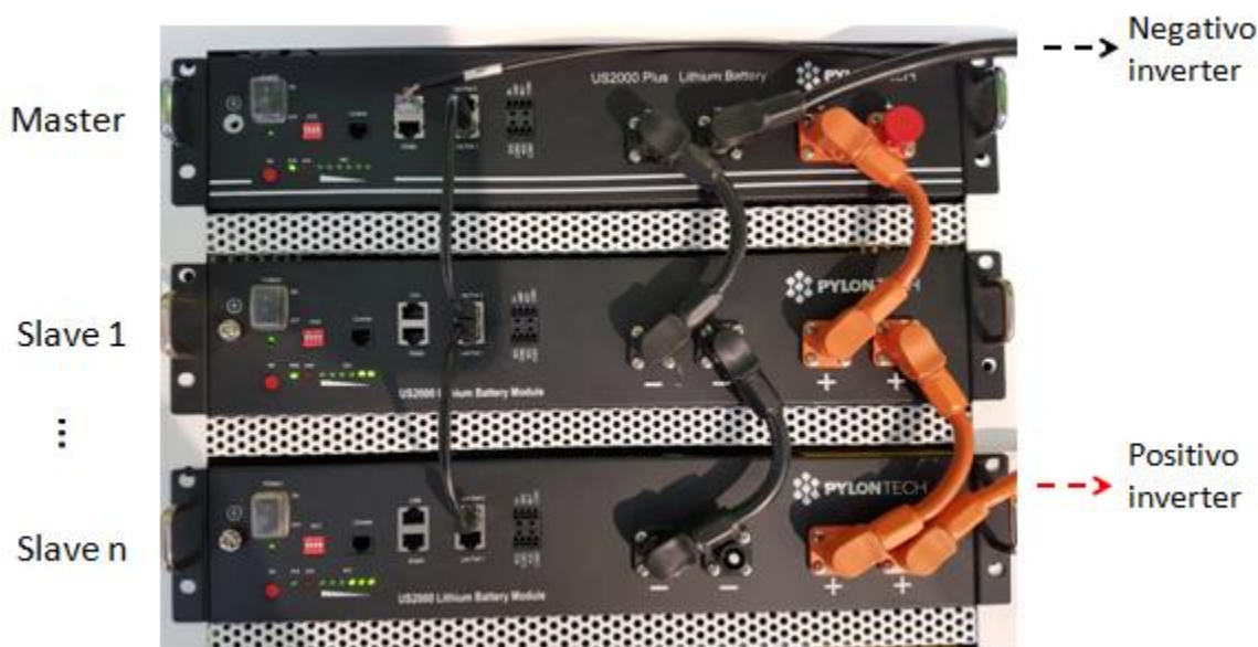
Figure 1 – Raccordement de trois batteries Pylontech en parallèle
