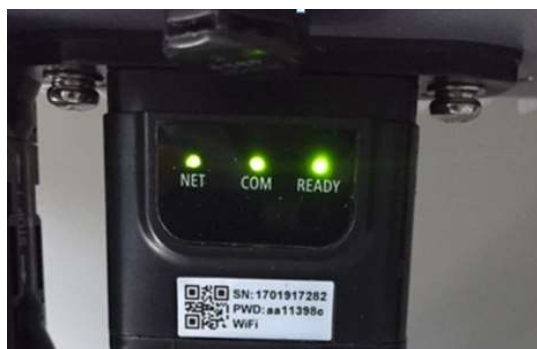
Figure 120 – État final des led
