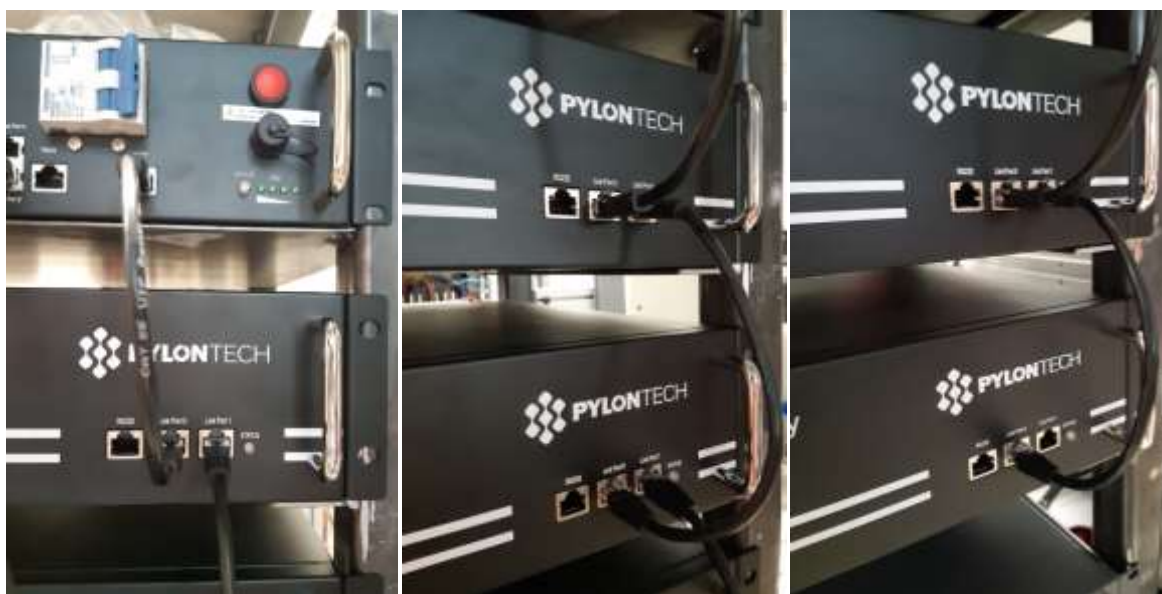
Figure 25 – Connexions de communication : BMS et premier module de batterie (à gauche), connexion entre les modules de batterie (au centre), connexion entre l'avant-dernier et le dernier module de batterie de la série (à droite)
