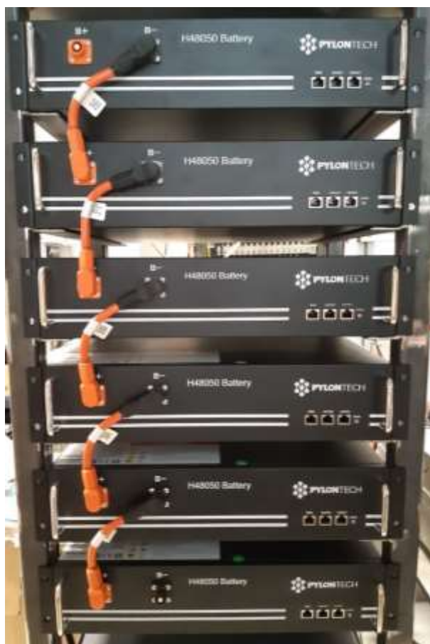
Figure 18 – Câblage de l'alimentation entre les modules de batterie
