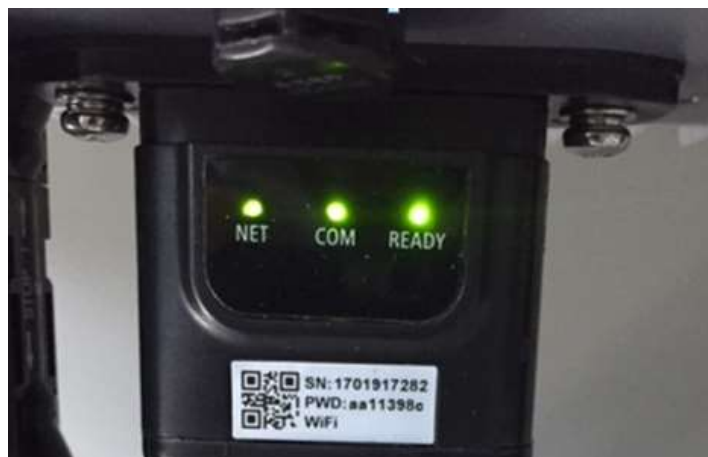
Figure 114 – État final des led
