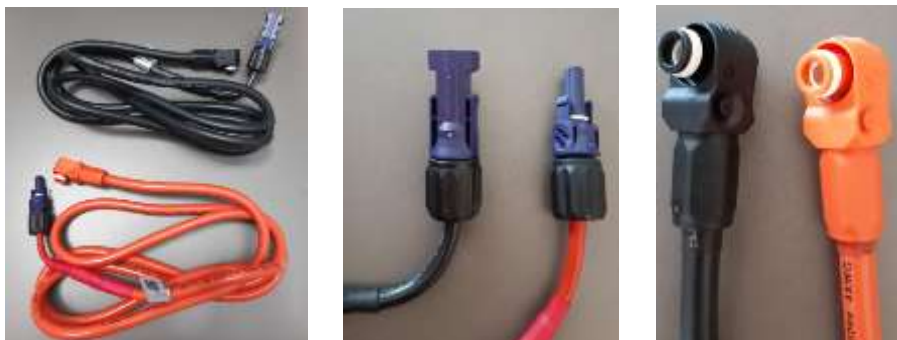
Figure 22 – Câbles d'alimentation BMS Onduleur (à gauche), bornes d'alimentation côté onduleur (au centre), bornes d'alimentation côté batterie (à droite)
